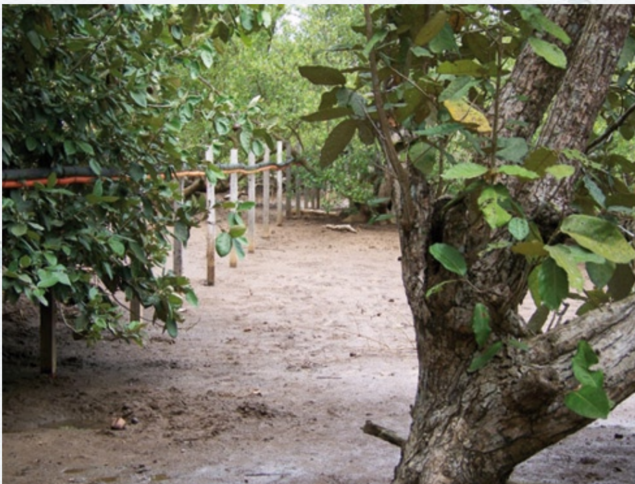
Les eaux circulent dans ces tuyaux entre la STEP et la mangrove
